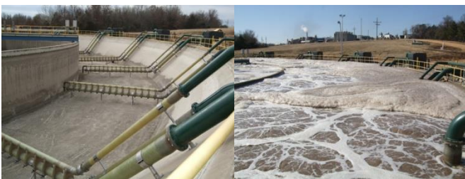
氧化渠生物曝氣槽
