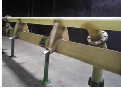
合鑫光電 MBBR 生物曝氣系統
