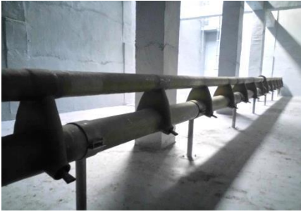
中油林園廠 MBR 薄膜生物曝氣系統
