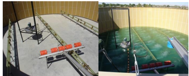
SBR 批次活性污泥槽
